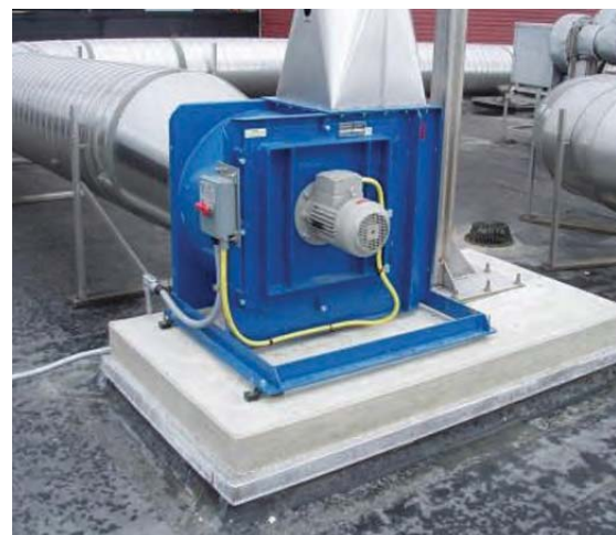
Ventilador colocado en el tejado.
